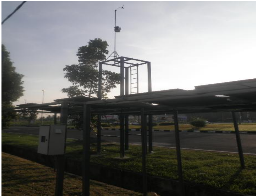
Gambar 6.19 Stasiun cuaca dan susunan panel surya (PV)
